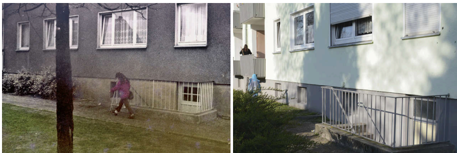
Abbildung 3.30: GLA · BR · 03 Detail des Hauses einer Nachkriegssiedlung des sozialen Wohnungsbaus. Die Sanierung des Hauses erscheint wohnwertorientiert, aber nicht umfassend. Das durchfeuchtete Mauerwerk des Kellerabgangs war 2015 nicht saniert. (Quelle: Scharioth und Schröppler 2017)
